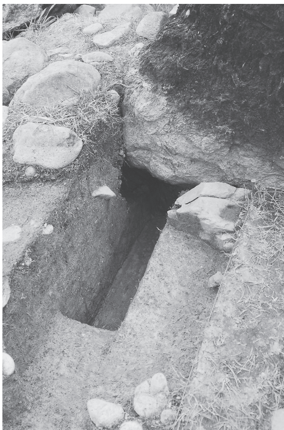
立石が傾いて発生した隙間 (西トレンチ)
